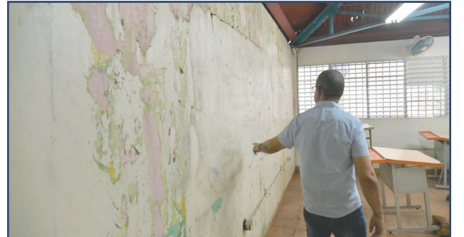
Catedrático Román Castillo, señalando el deterioro en una de las aulas en la Facultad de Artes.
